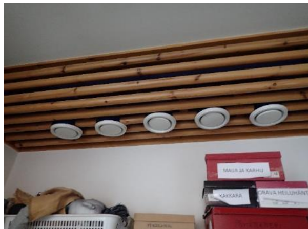
Kuva 63. Poistoilman päätelaitteita rakennuksen tiloissa (1091).
