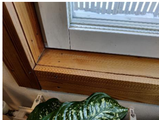
Kuva 35: Ikkunaliittymät ovat epätiivitä.
