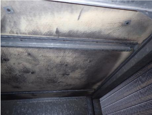
Kuva 54. Puhallinkammion äänenvaimennusmateriaalina on villa.
