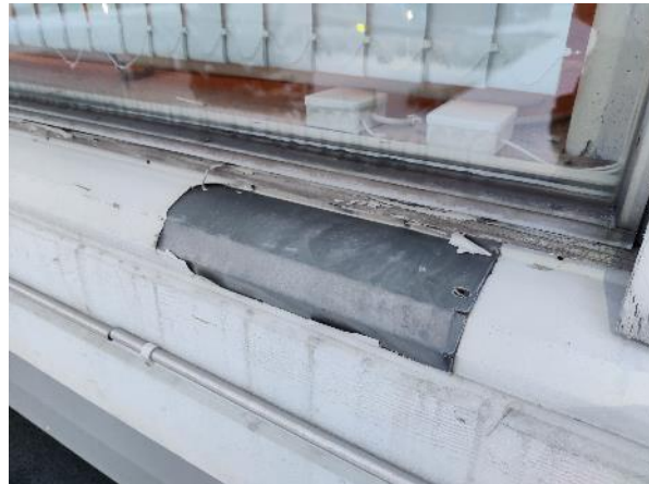
Kuva 14: Puurakenteisilla osilla ikkunapellitykset ovat paikallisesti epätiivit ja kallistuksiltaan loivat. Ikkunoiden ulkopuitteiden maalipinnat ovat paikallisesti huonokuntoisia.
