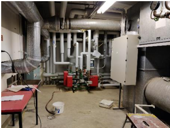
Kuva 29: Toisessa kerroksessa sijaitseva ilmanvaihtokonehuone.
