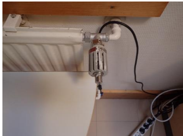
Kuva 65. Alkuperäinen patteriventtiili ja toimilaite.
