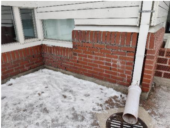
Kuva 2: Kosteusjälkiä ulkoseinärakenteissa tiiliverhoilussa.
