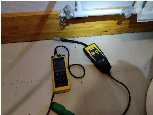
Kuva 36: Merkkiainevuotoa ulkoseinän ja lattia rajassa.
