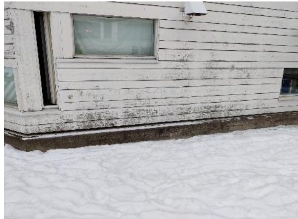
Kuva 3: Kosteusjälkiä lautaverhoilussa ja sokkelirakenteessa
