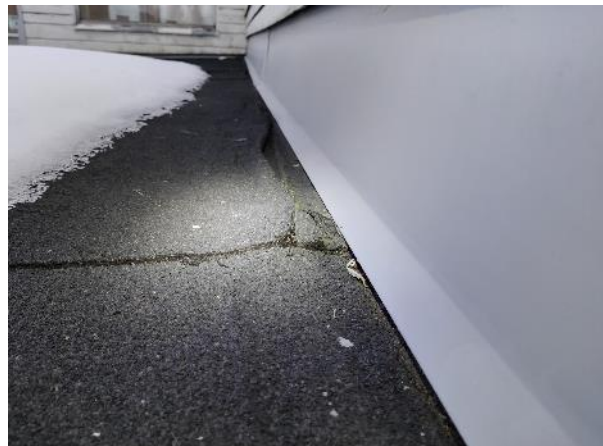
Kuva 45: Vesikatteenä todettavissa pintavaurioita
