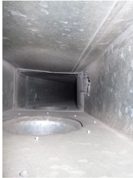
Kuva 61. Poistoilman pölykertymä ei ole yleisesti ottaen merkittävä (tila 1091).
