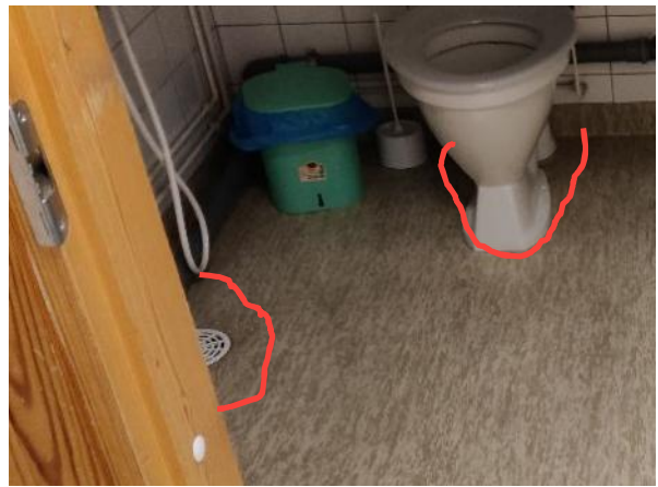
Kuva 18: Lattiakaivojen ja wc-istuinten ympäristöissä havaittiin lieviä poikkeamia.
