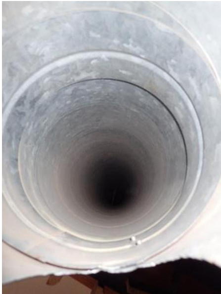
Kuva 58. Tuloilmakanavassa havaittavissa hieman pölyisyyttä.
