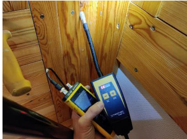
Kuva 37: Ulkoseinien ja pilareiden liittymät ovat epätiivitä.
