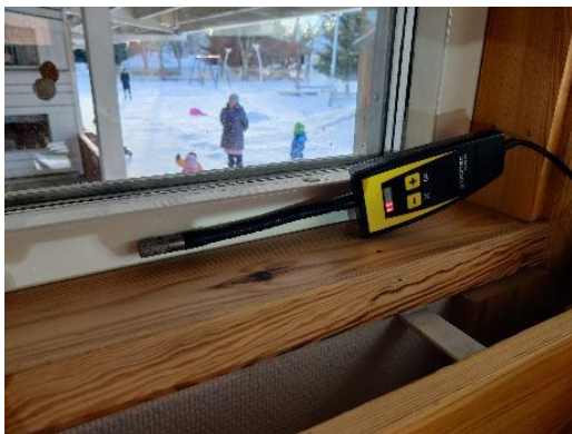
Kuva 34: Ikkunaliittymät ovat epätiivitä.
