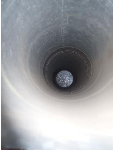
Kuva 60. Poistoilmakanavan pölykertymä on hieman tulokanavaa suurempi (tila 1038/1043 käytävä).
