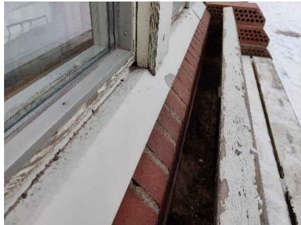
Kuva 12: Vesipellin päällä mahdollisesti liikkuva vesi ohjautuu tiiliseinälle.
