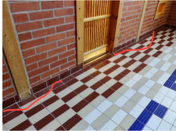
Kuva 20: Allashuoneen lattiassa reuna-alueella lievä poikkeamaa.
