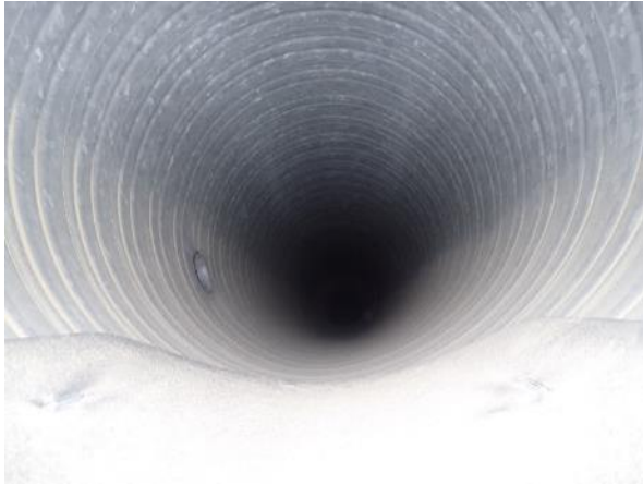
Kuva 56. Tuloilmakanava 1002 tilan alakatossa.
