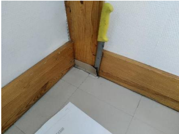
Kuva 27: Lattian ja pilarien liitoskohdat epätiivitä.
