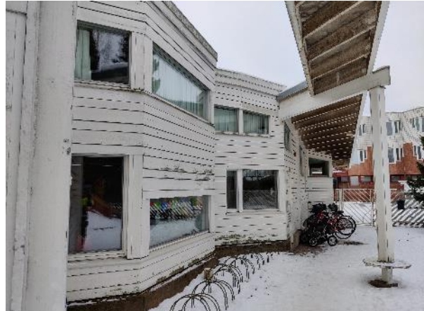
Kuva 5: Rakennuksen räystäsrakenteet ovat lyhyet ja rakennuksesta erillisenä osana olevat "lipat" jopa ohjaavat kosteuskuormaa rakennusta kohti.
