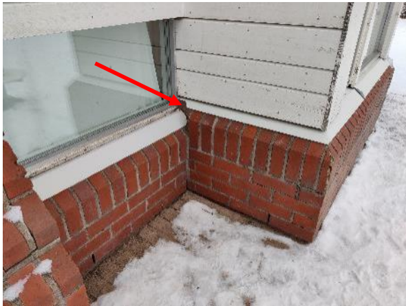
Kuva 11: Tiiliverhoillulla osilla vesipellitykset ovat epätiivit.
