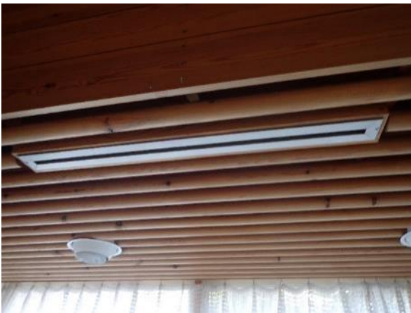
Kuva 62. Tuloilman päätelaitte rakennuksen tiloissa (1099).
